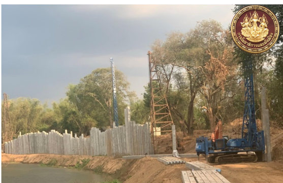
ระบบป้องกันน้ำท่วม อ.ศรีมหาโพธิ จ.ปราจีนบุรี
