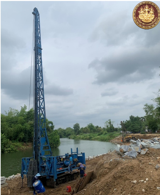
เขื่อนป้องกันตลิ่งริมแม่น้ำคลองพระสทิง อ.เมือง จ.สระแก้ว
